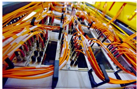
Cables connectats a un detector
